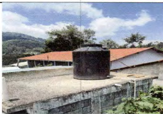
Foto 4: Sustrucción deposito de agua
